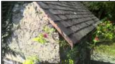
Photo N° 004 -Extérieur-Abris- Plafonds-Ardoise synthétique (Fibres-ciment)
