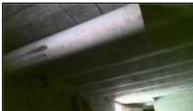
Photo N° 001 -S.sol-Cave 1 S.sol- Gaines et coffres horizontaux- Ventilation haute (Fibres-ciment) X2
